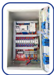
ตู้ไฟฟ้าภายใน
