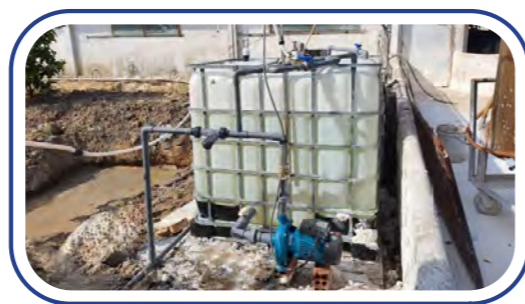
ถังและปั๊ม
