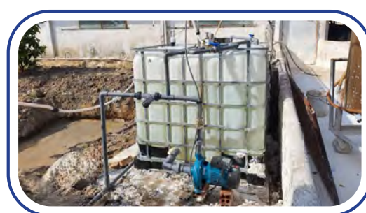
タンクとポンプ
