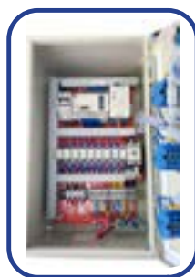
Tủ điện bên trong
